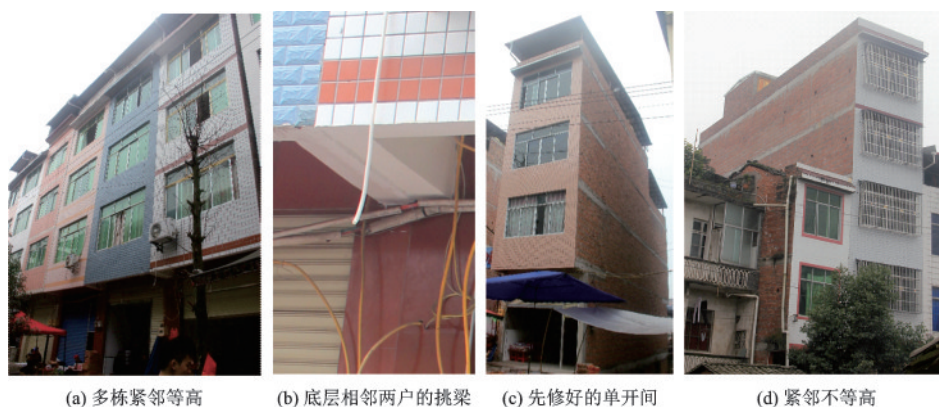
图2 四川开江县任市镇自建单开间砌体房屋(2015年)
