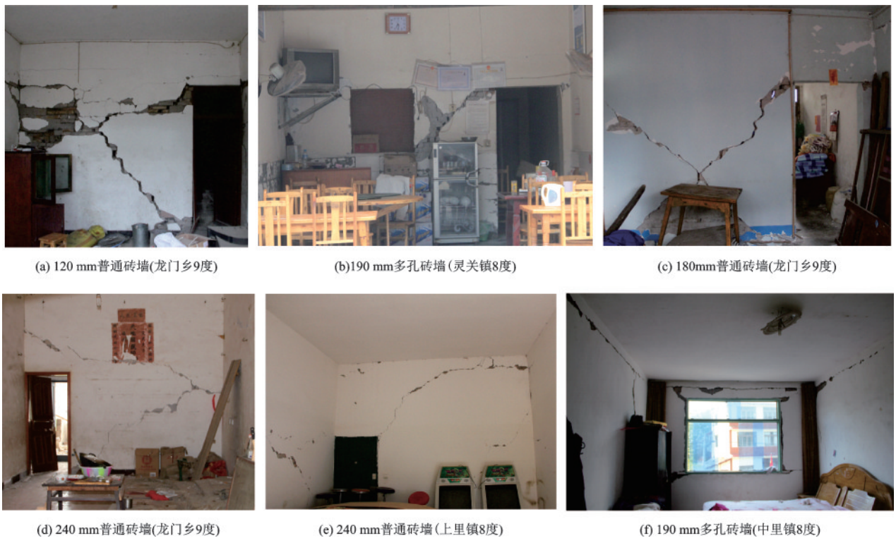
图4 纵墙震害现场照片
