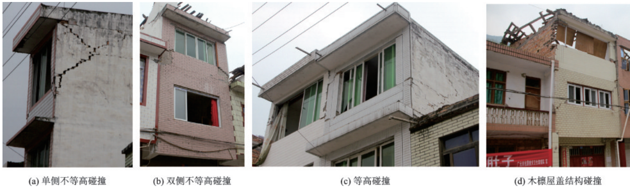
图7 芦山县9度区三层单开间砌体房屋碰撞震害照片
