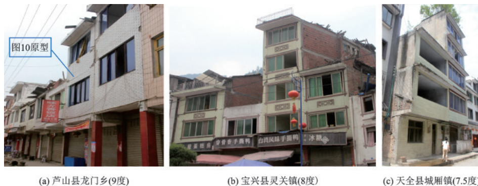
图1 芦山地震单开间临街砌体房屋震害照片(2013年)
